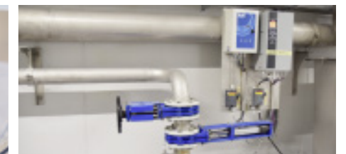
AVK spadeventiler med lineære aktuatorer på rør til rejektivand. De lineære aktuatorer er energieffektive sammenlignet med pneumatisk aktuatorer.
